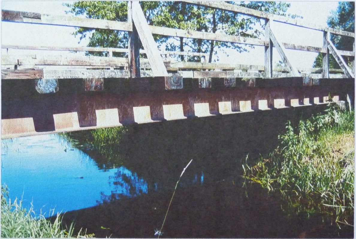
Foto.2. Widok konstrukcji niosącej mostu, dźwigary – dwuteowniki stalowe h=450 mm, drewniane belki ustroju nośnego 160 \times 250 mm, drewniana jezdnia grubości 120 mm.
