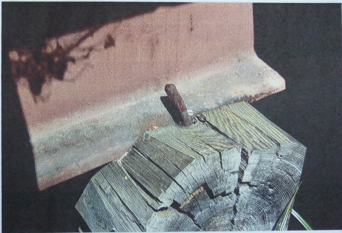
Foto.5. Widok zniszczonego drewnianego oczepu.
