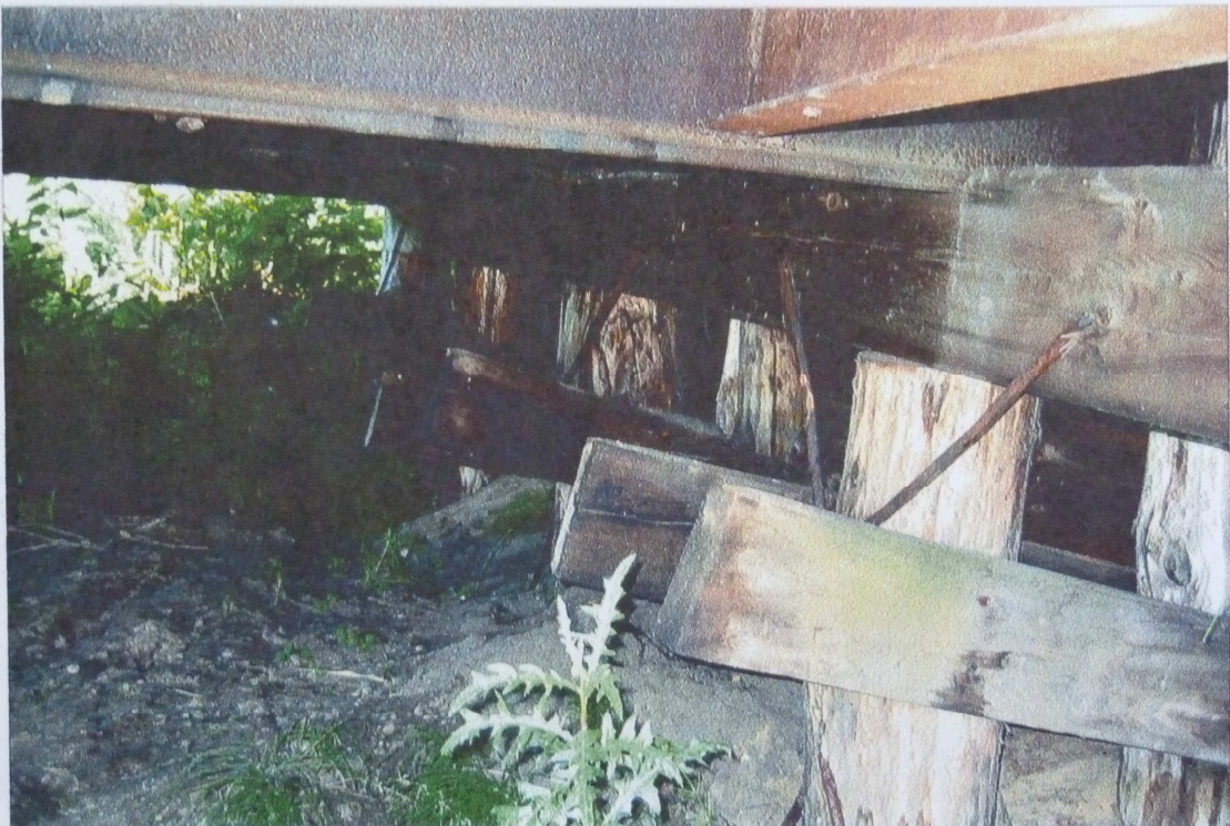
Foto.3 i 4. Widok zniszczonych elementów drewnianej konstrukcji nośnej mostu, pali, oczepów i ścian przyczółków.
